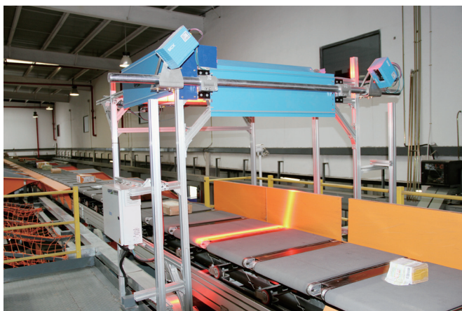
2015年，西安邮区中心局草滩处理中心安检机投入使用 (王君霞)
