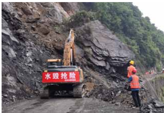
2020 年 6 月 21 日，安康公路管理局养护工人清理道路塌方（安康公路管理局）
