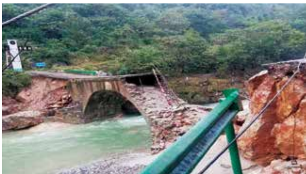
2021年9月21日，洋县溢水镇木家村通村道路桥梁被水冲毁（闫卫飞）
